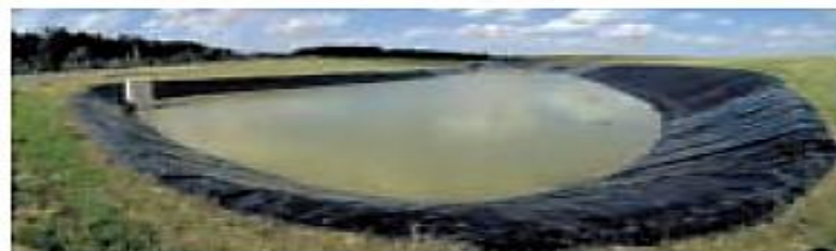
Bassin de rétention sur l'aérodrome de Angers-Marcé
